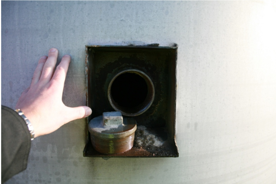
Bild 3: Nahansicht einer Revisionsöffnung des Abzugs, die für die Messungen genutzt wurde.
